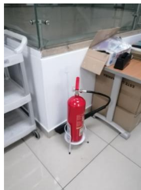
Extintor de CO2
