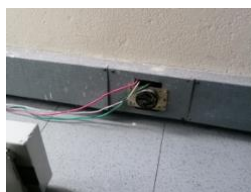
Ilustración 93 Detalle instalación eléctrica
