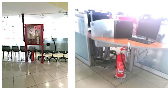
Ilustración 84 Equipos de control de emergencias
